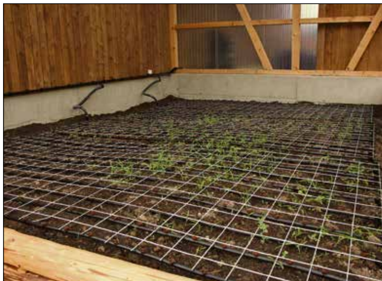
Mit Düsen wird das Wassergemisch auf dem Biobed verteilt.
